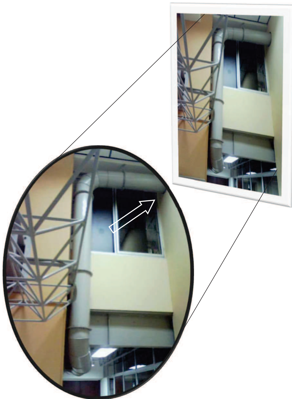
Figura A.III.17. Factores de riesgo que propician la propagación del incendio. Conductos de climatización carentes de seccionadores automáticos.
