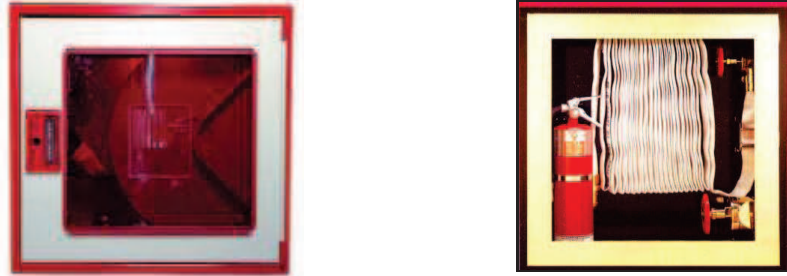
Figura 1.12. Bocas de incendio equipadas de 45 mm. (APCI, 2009)
