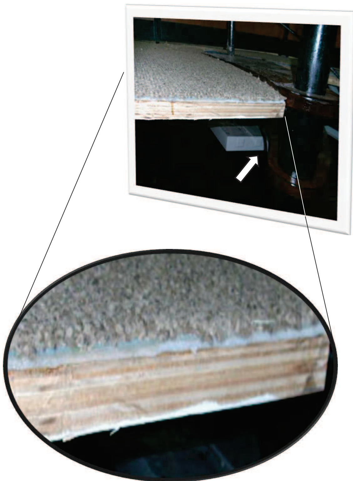
Figura A.III.8. Factores de riesgo que propician la propagación del incendio. Abertura que comunica dos plantas, con escalera y peldaños de madera por el interior de una oficina. Entrepiso de madera recubierto con alfombra.
