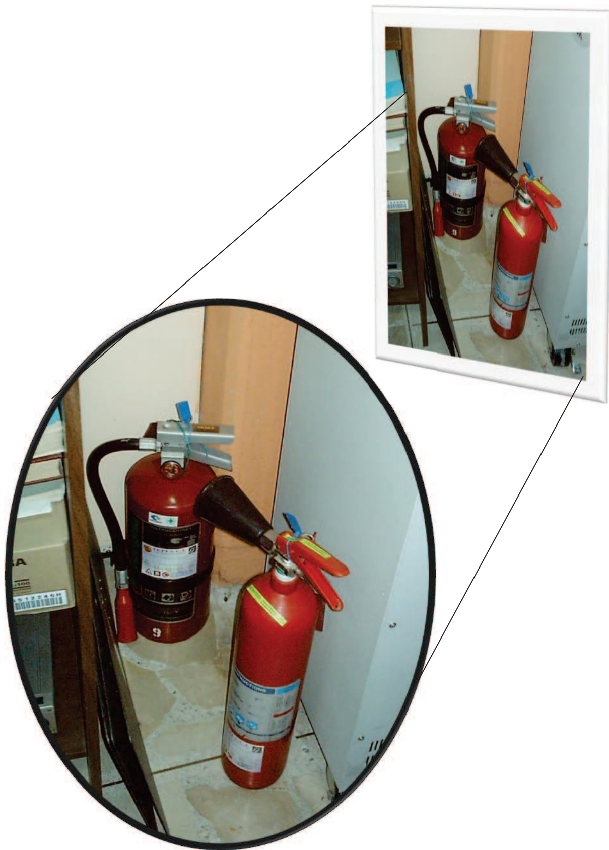
Figura A.III.20. Factores de riesgo que dificultan la extinción del incendio. Medios de extinción primaria ubicados en el suelo.
