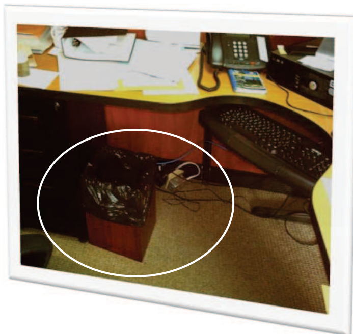
Figura A.III.1. Factores de riesgo que posibilitan el surgimiento de incendio. Materiales combustibles próximos a líneas eléctricas sobrecargadas.
