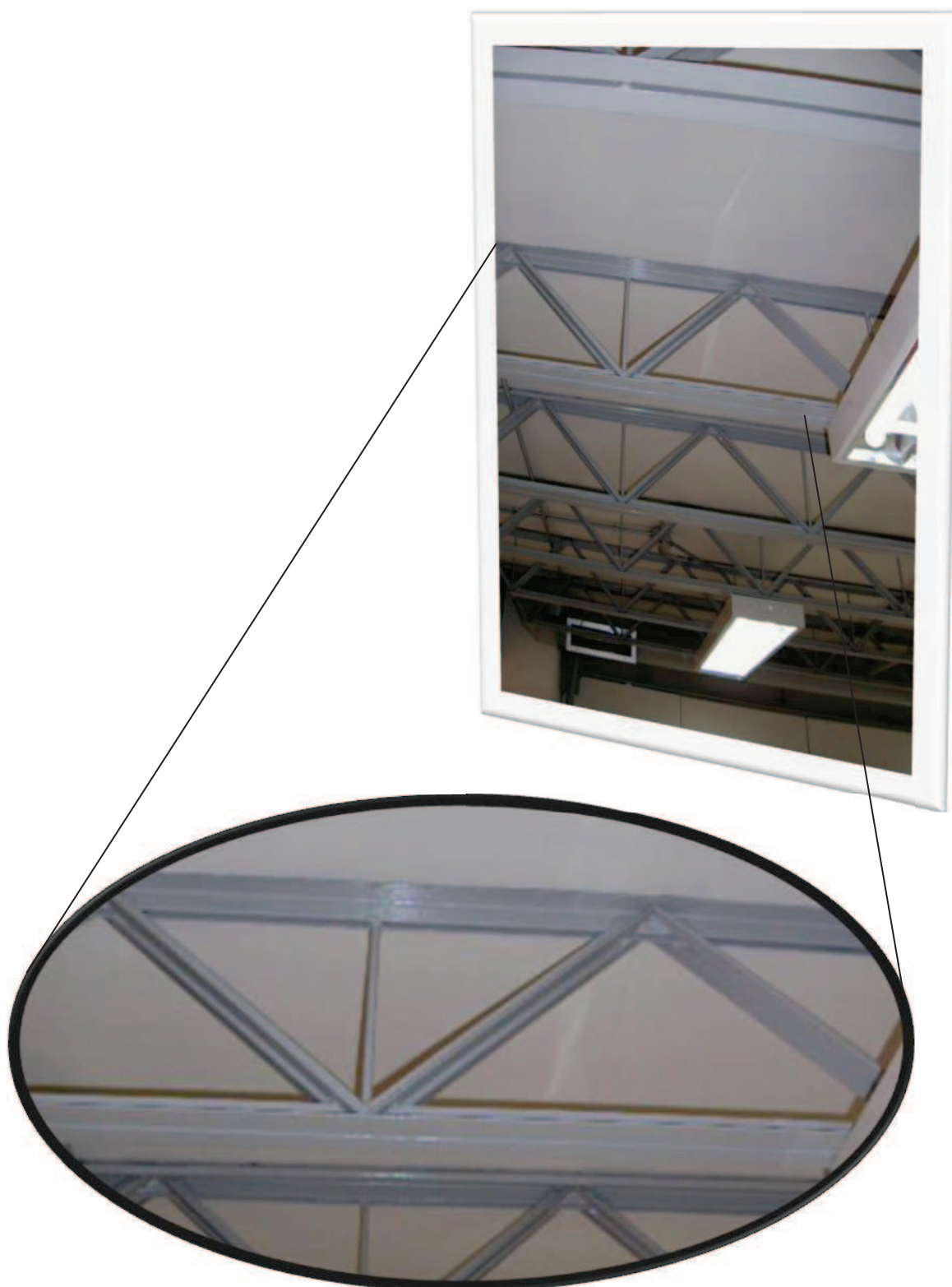
Figura A.III.14. Factores de riesgo que dificultan la extinción del incendio. Vigas metálicas no protegidas.
