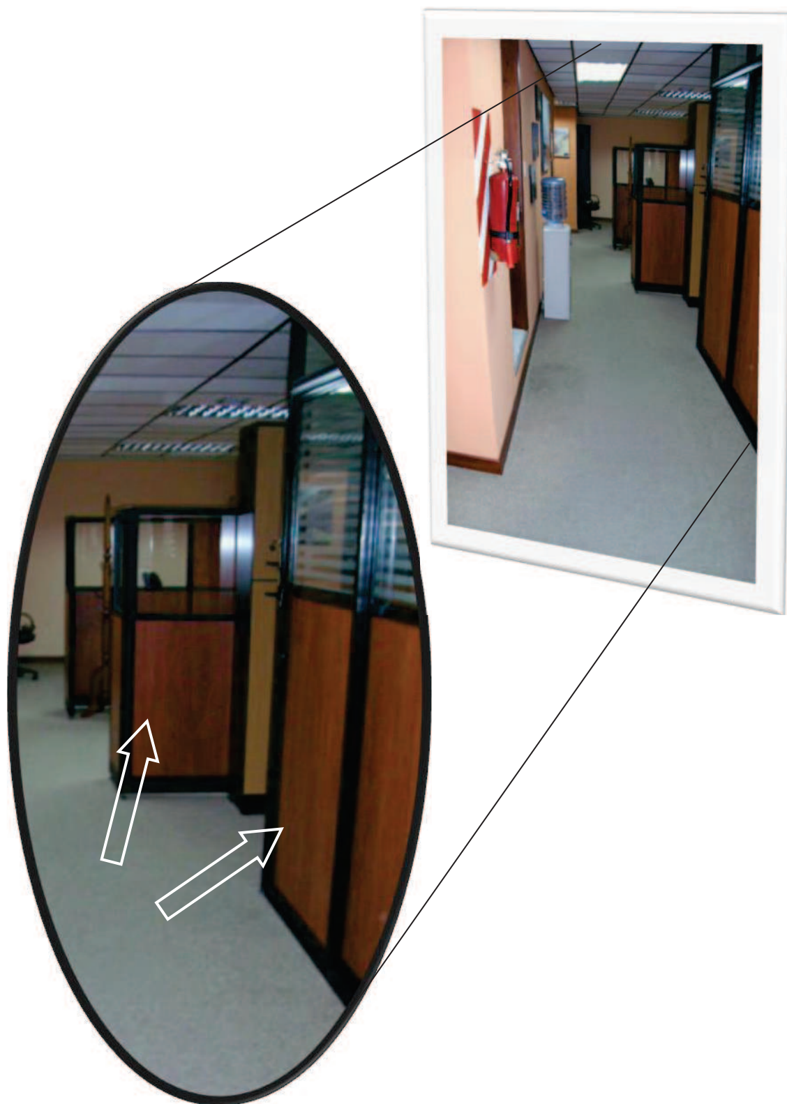
Figura A.III.18. Factores de riesgo que propician la propagación del incendio. Tabiques divisorios no poseen la resistencia al fuego requerida.
