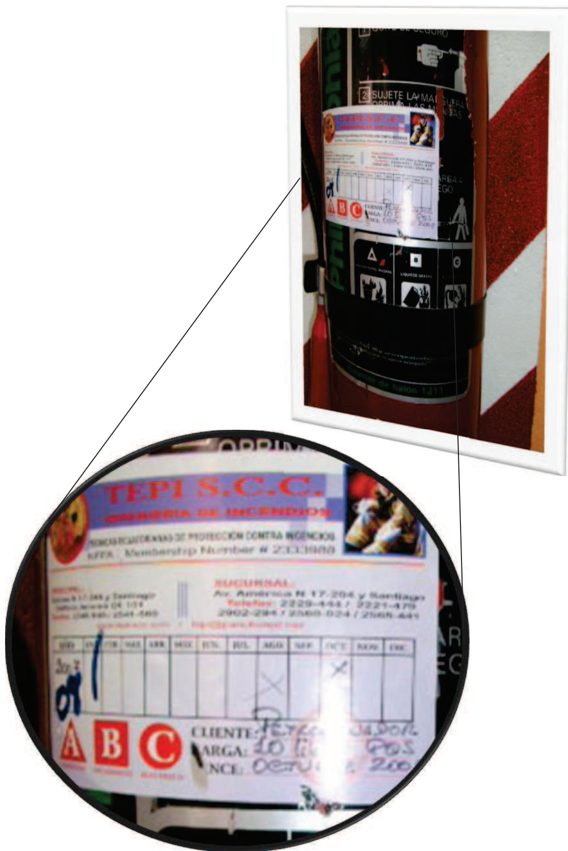
Figura A.III.19. Factores de riesgo que dificultan la extinción del incendio. Medio de extinción primaria carente de mantenimiento.
