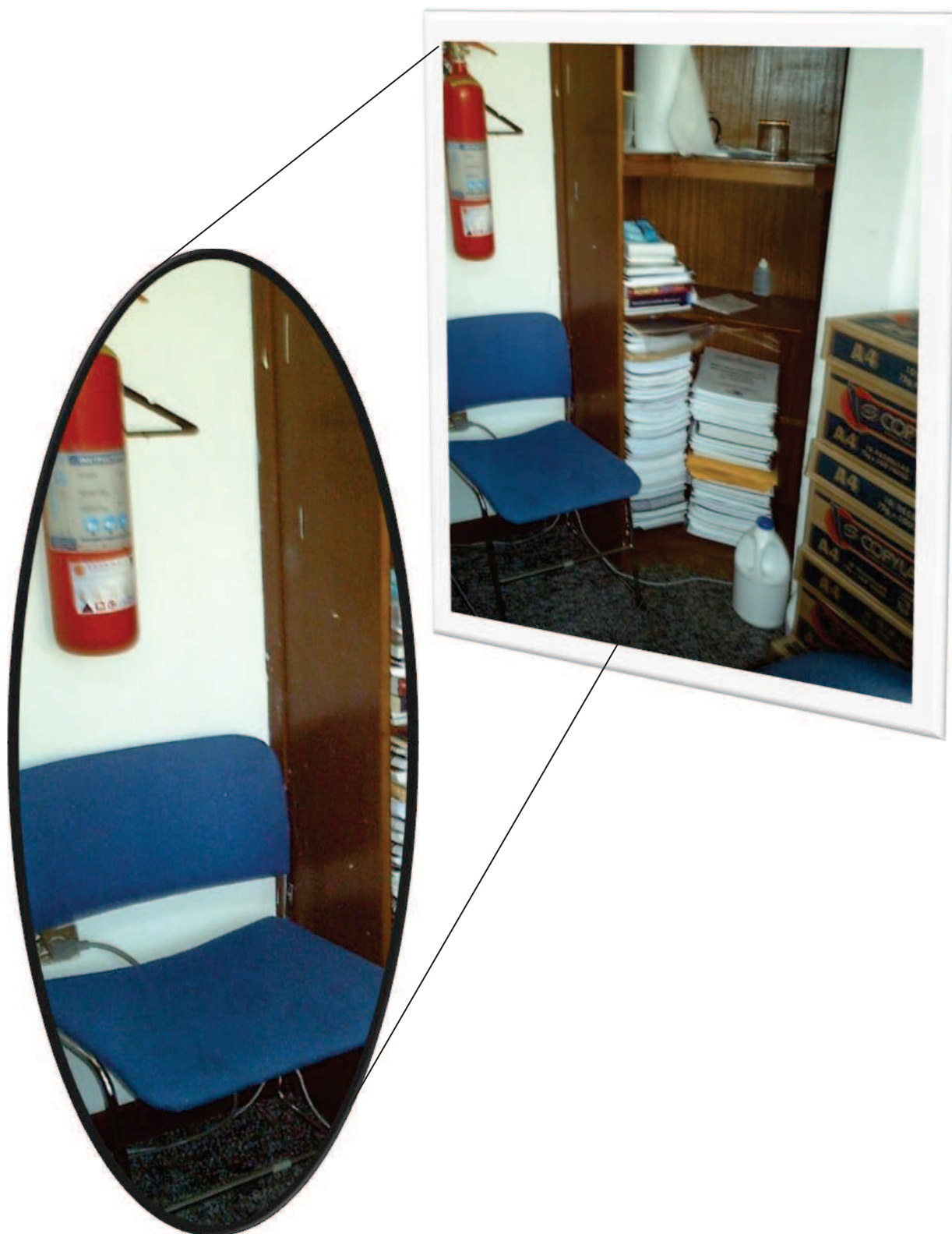
Figura A.III.10. Factores de riesgo que dificultan la extinción del incendio. Medio de extinción primaria obstruido.
