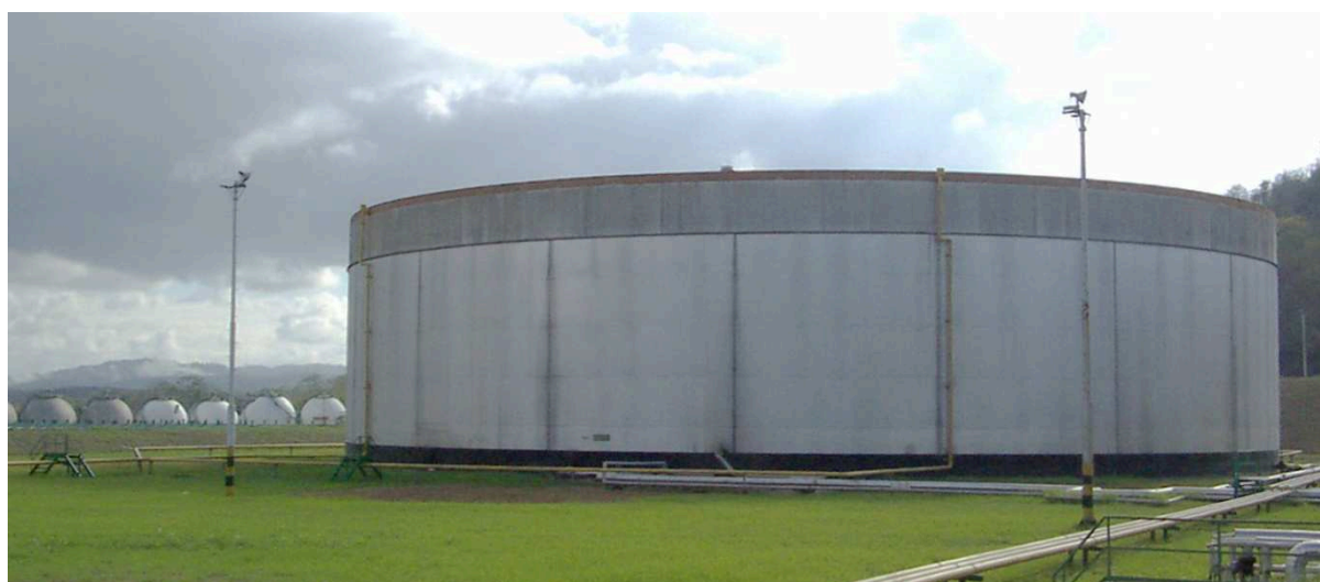
Figura 4.2 Tanque de almacenamiento de Petróleo, con techo cónico soportado (API.650)
