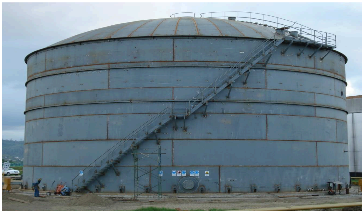
Figura 4.1 Tanque de almacenamiento de Nafta, con techo domo auto-soportado (API.620)
