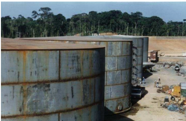
Figura 2.5 Tanques con techo cónico
