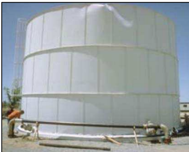
Figura 3.79c Pandeo generado en la pared del tanque debido al levantamiento de 14" de la base.
