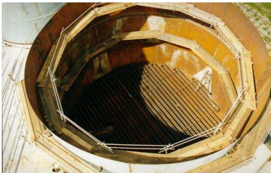
Figura 2.78 Serpentin tubular para calentamiento de un tanque de almacenamiento
