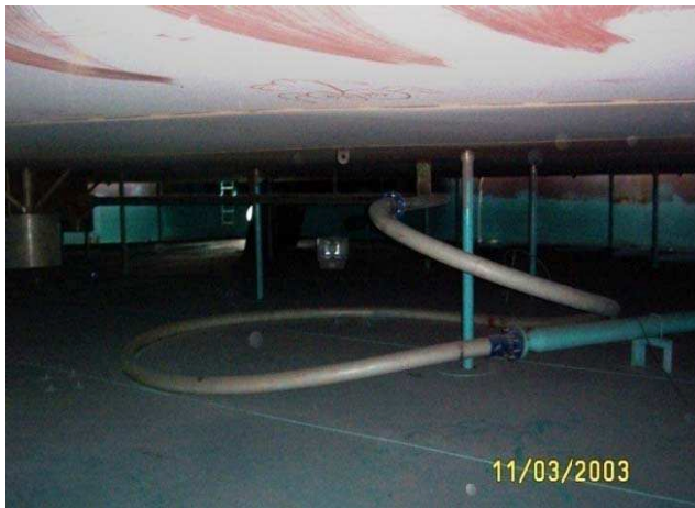
Figura 2.51 Drenaje flexible y soportes de techo
