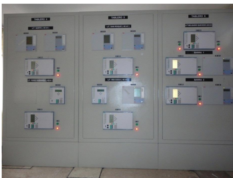
Figura 2. 17.- Tableros 4, 5 y 6 de control, protección y medición de 46 kV de la S/E Selva Alegre.
