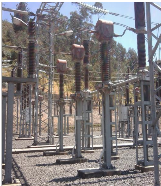
Figura 2. 6.- Transformadores de Corriente del patio de 138kV de la S/E Selva Alegre.
