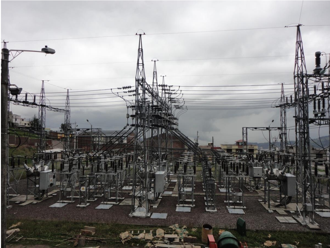
Figura 2.4.- Patio de maniobras de 46 kV (Disyuntor y Medio)
