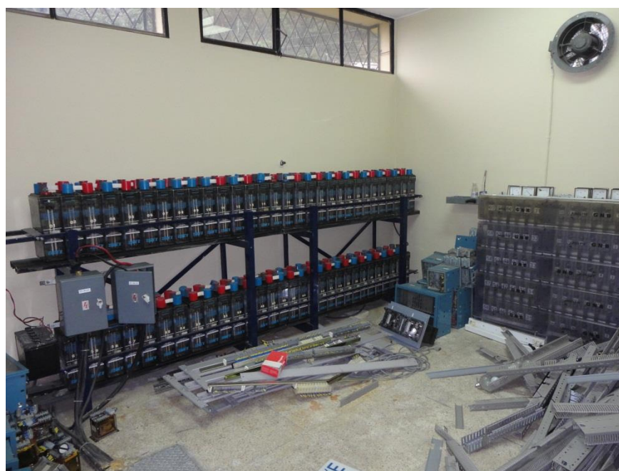
Figura 2. 30.- Cuarto de Baterías de la S/E Selva Alegre.
