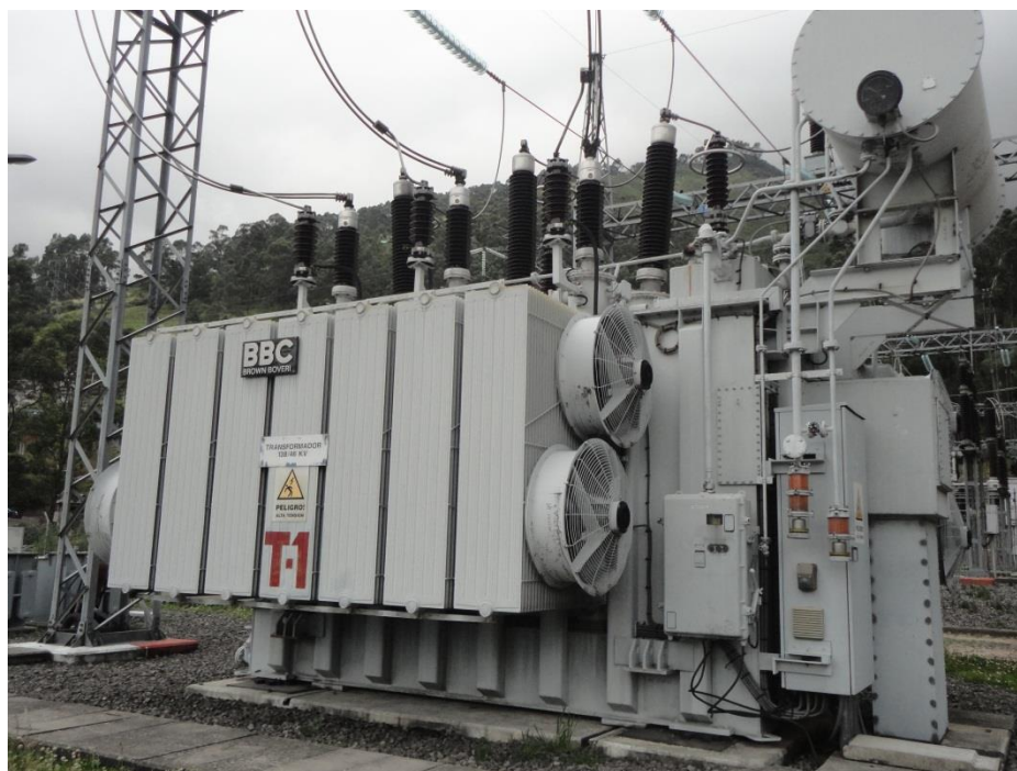
Figura 2. 12.- Transformador 1 de la S/E Selva Alegre.
