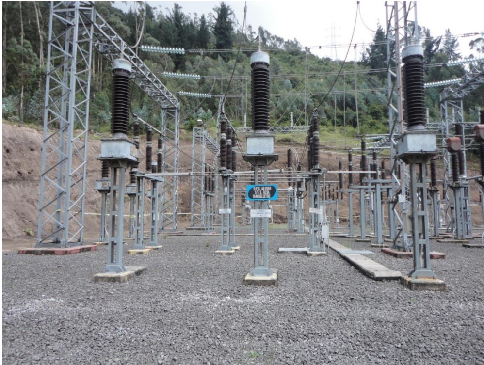
Figura 2. 9.- Transformadores de Voltaje del patio de 138kV de la S/E Selva Alegre.
