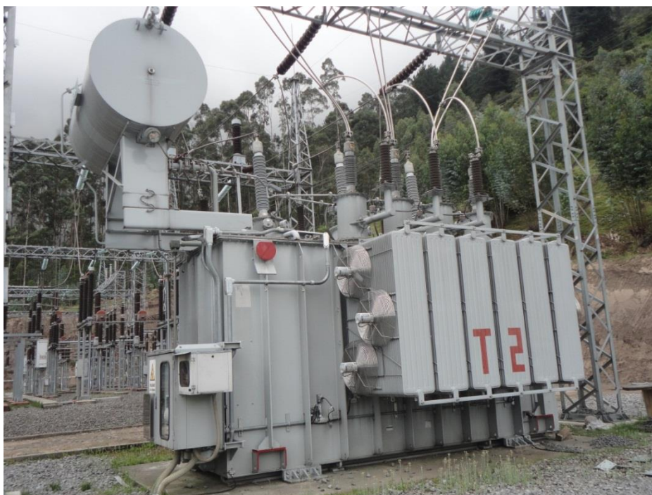
Figura 2. 13.- Transformador 2 de la S/E Selva Alegre.
