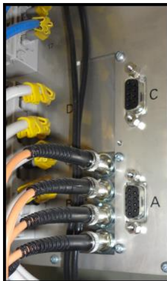
Figura 2. 32.- Puertos de Fibra Óptica de los IEDs SIEMENS (Vista posterior).
