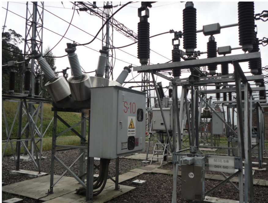
Figura 2. 5.- Disyuntor S-10 del patio de 46kV de la S/E Selva Alegre.
