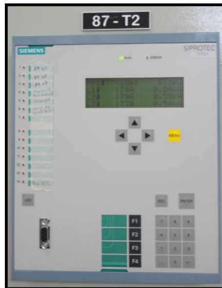
Figura 2. 19.- IED SIEMENS 7UT613 (protección 87-T)
