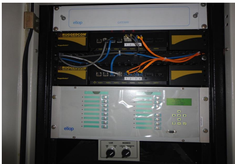
Figura 2. 22.- RTU ELIOP instalada en la S/E Selva Alegre.
