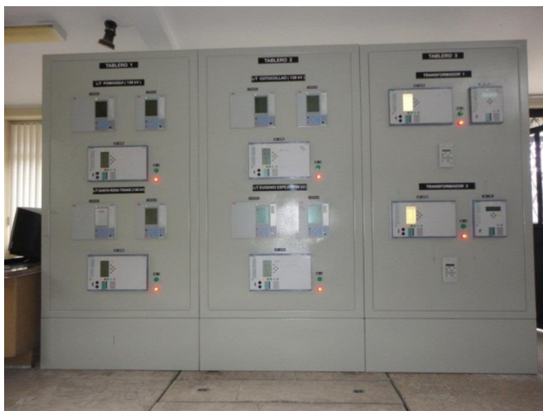
Figura 2. 16.- Tableros 1, 2,y 3 de control, protección y medición de 138 kV de la S/E Selva Alegre.
