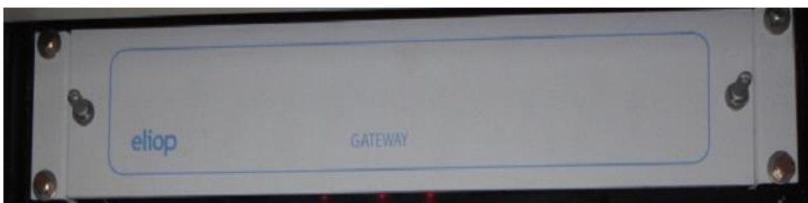
Figura 2. 23.- Gateway ELIOP instalada en la S/E Selva Alegre.
