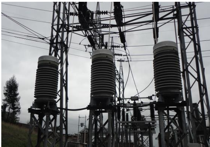
Figura 2. 11.- Transformadores de Voltaje del patio de 46 kV de la S/E Selva Alegre.
