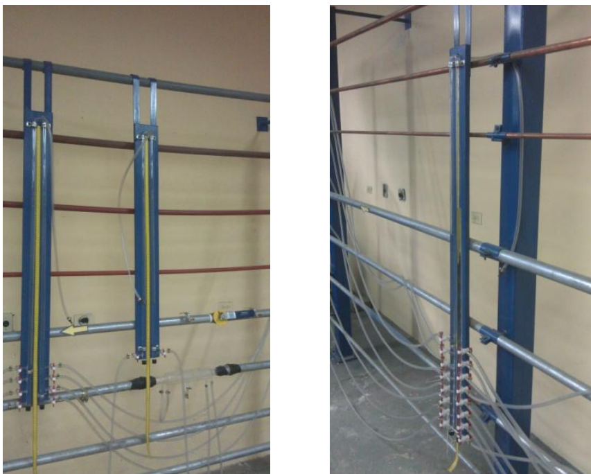
Figura 3.4. Manómetros de 16 válvulas, 8 válvulas y 2 válvulas
