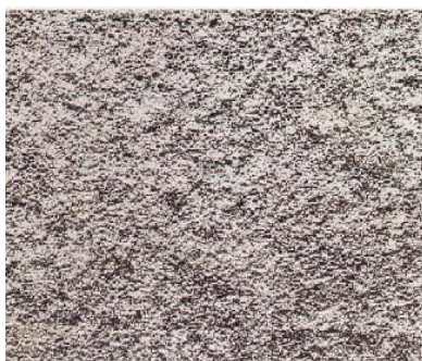
Figura 1. 6: Grado “C” preparada con un nivel de preparación de superficie equivalente a SA 1
