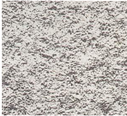
Figura 1. 13: Grado “D” preparada con un nivel de preparación de superficie equivalente a SA 2 ½
