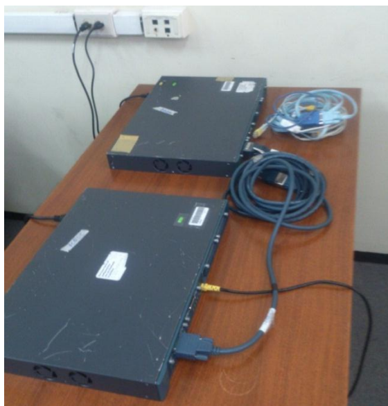
Figura 3.16: Routers c1700 facilitados por el laboratorio de la facultad.
