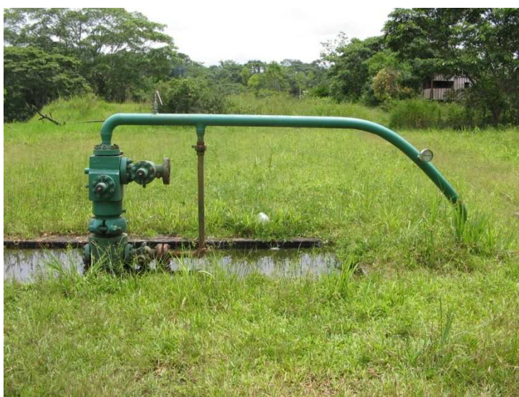
Figura 3.18: Cabezal del pozo inyector Auca-12.
