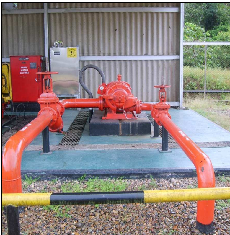
Foto No 2.26. Bomba Eléctrica Marca MARATHON, 150 HP.
