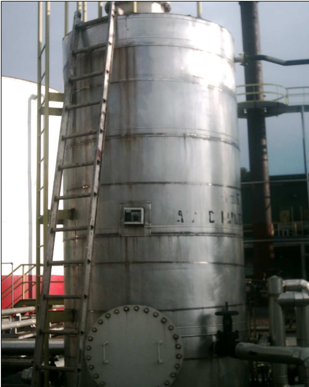
Foto No 5.8. Tanque de Almacenamiento de Crudo para Generadores.
