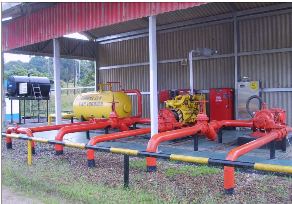
Foto No 2.25. Bombas y Tanque Horizontal de Espuma.
