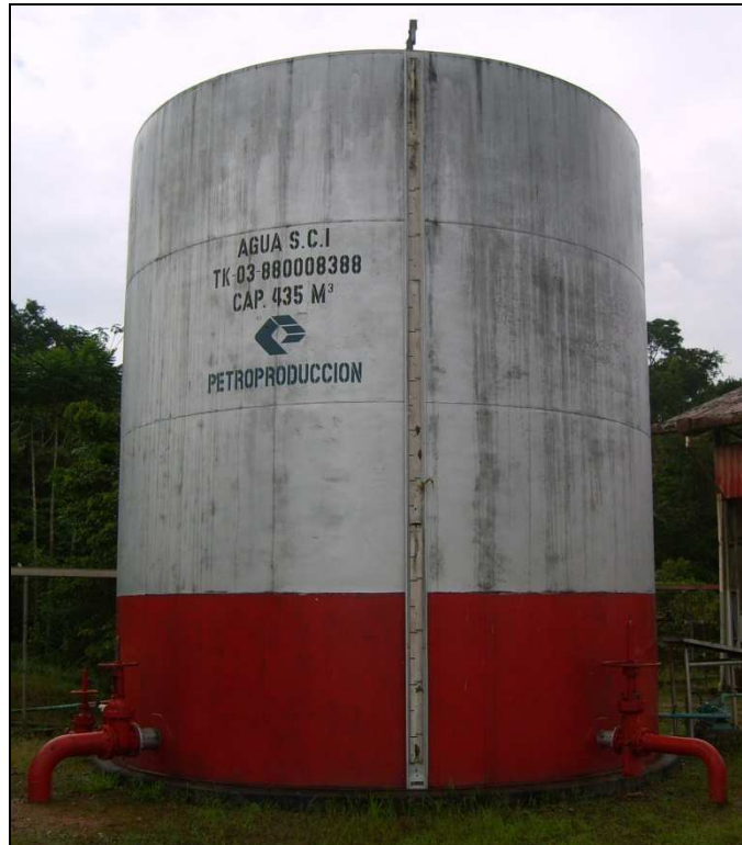
Foto No 2.24. Tanque de Almacenamiento de Agua (3000 Barriles).
