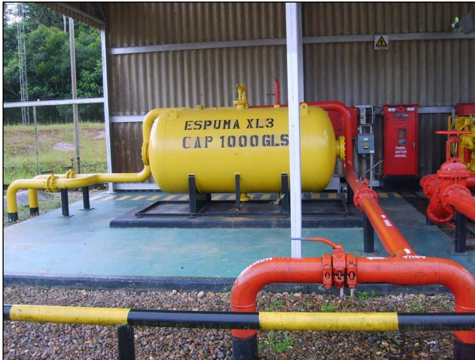
Foto No 2.28. Tanque de Espuma (1000 Barriles).
