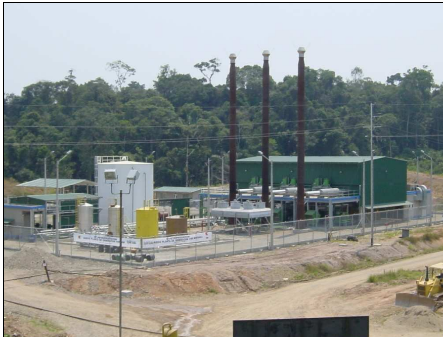
Foto No 5.1. Vista panorámica de la Planta de Generación Eléctrica del Campo V.H.R.
