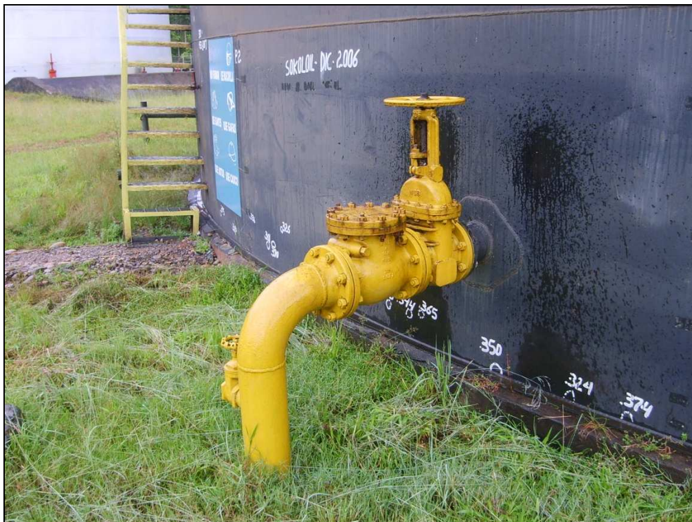
Foto No 2.23. Línea de entrada de recirculación a Tanque de Lavado.
