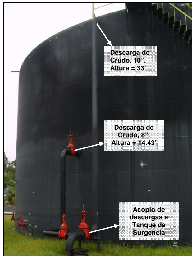
Foto No 2.14. Juego de Tuberías y Válvulas de Descarga de Tanque de Lavado.
