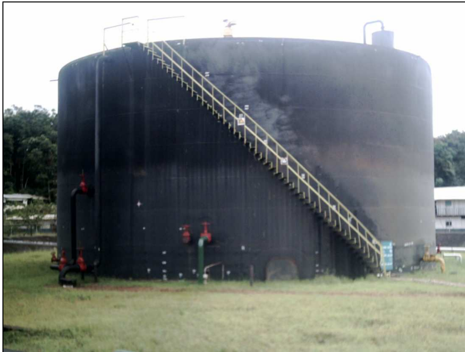
Foto No 2.13. Tanque de Lavado (24680 Barriles).
