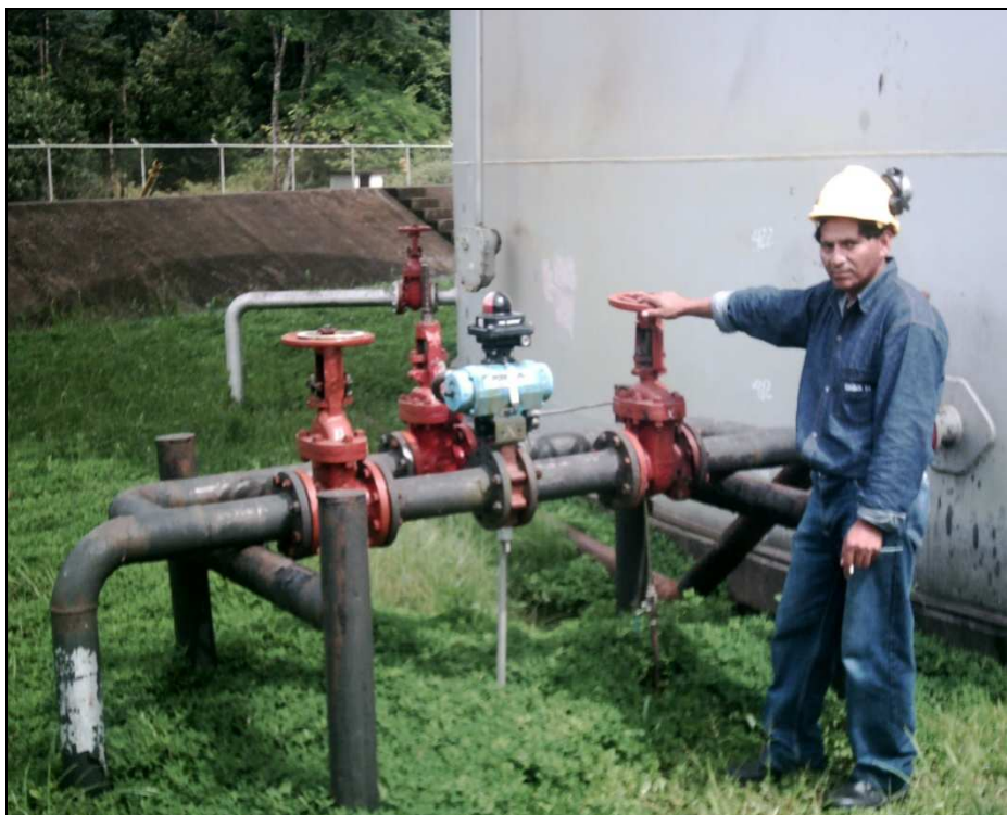
Foto No 2.21. Juego de Tuberías y Válvulas del Sistema de Recirculación.
