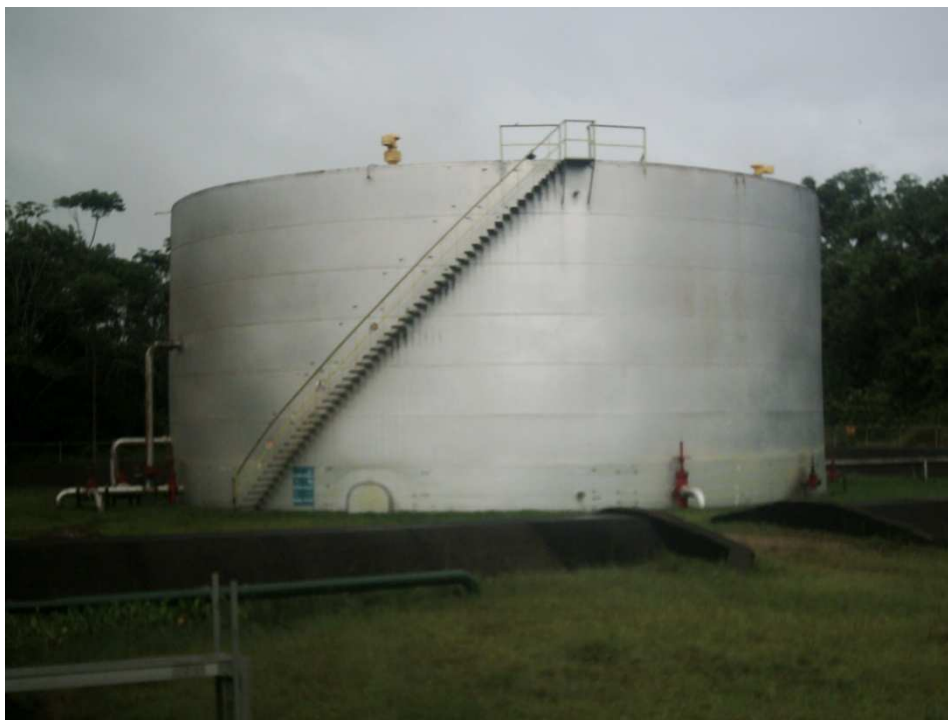
Foto No 2.15. Tanque de Surgencia o Reposo (32230 Barriles).
