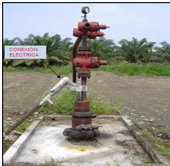
Figura 1.4 CABEZAL DEL POZO
