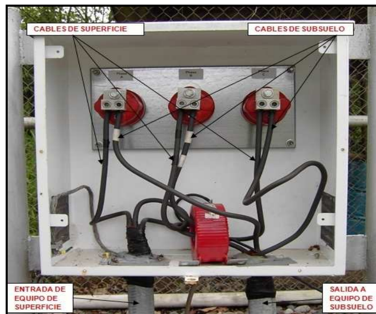
Figura 1.5 CAJA DE CONEXIONES
