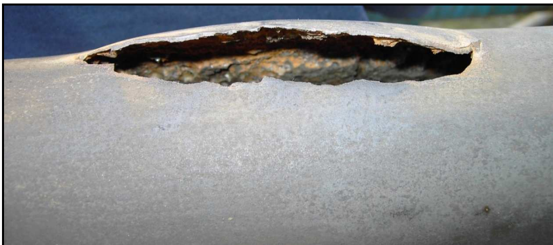
Figura 4.10 HUECO EN TUBERÍA
