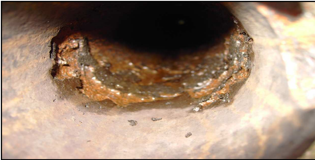
Figura 4.11 PROBLEMAS CON LA TUBERÍA
