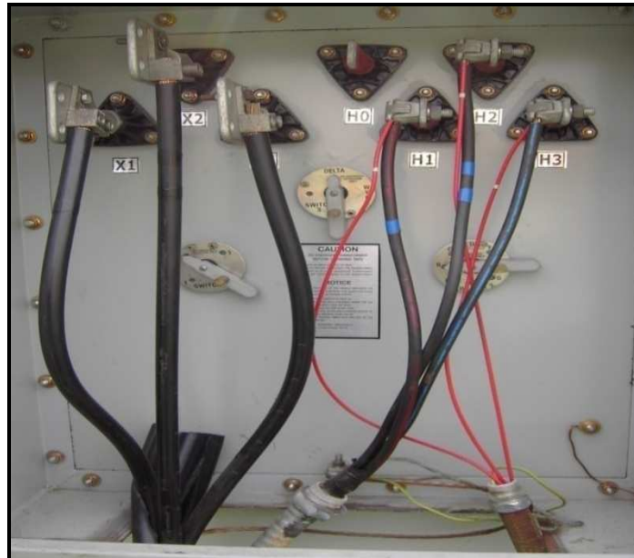
Figura 1.8 TAPS DEL PANEL DEL TRANSFORMADOR
