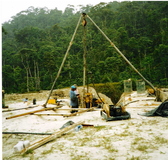
Foto 12. Pozo 27 (UTM: 693200E, 9847700N). Realización de una perforación a roto - percusión, con diamantina.
