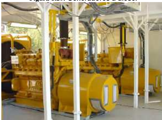
Figura 1.20: Generadores a diesel
