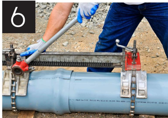
Gráfica 4.23 Tubería de PVC que se utilizará como tubería de presión
