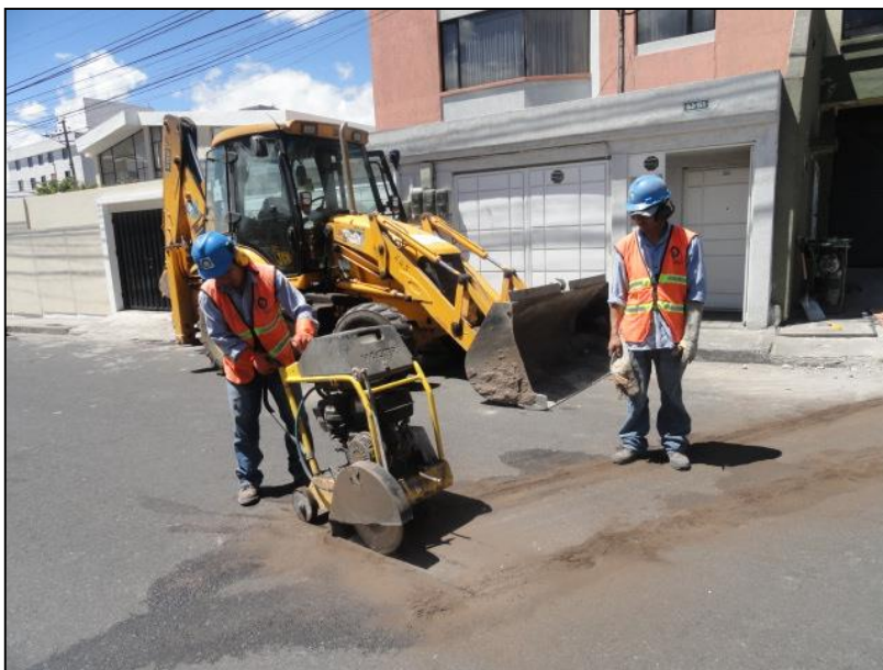
Figura 1.11. Fotografía que muestra la rotura de concreto para reparación de una tubería colapsada
