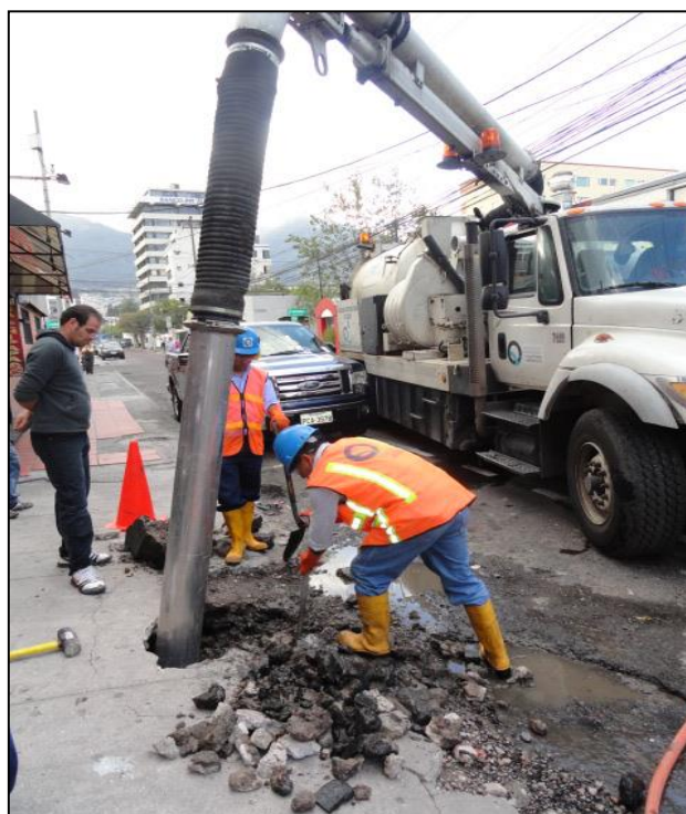
Figura 1.9. Fotografía que muestra una desobstrucción de conexión domiciliaria con el uso de equipo de hidrosucción
