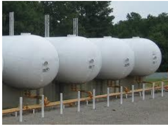
Figura 2.5. Recipientes en ambiente de temperatura elevada
