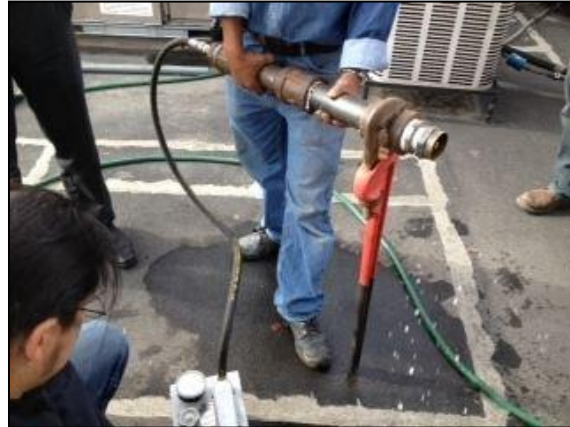
Figura 3.20. Banco de prueba portátil para válvula de alivio
