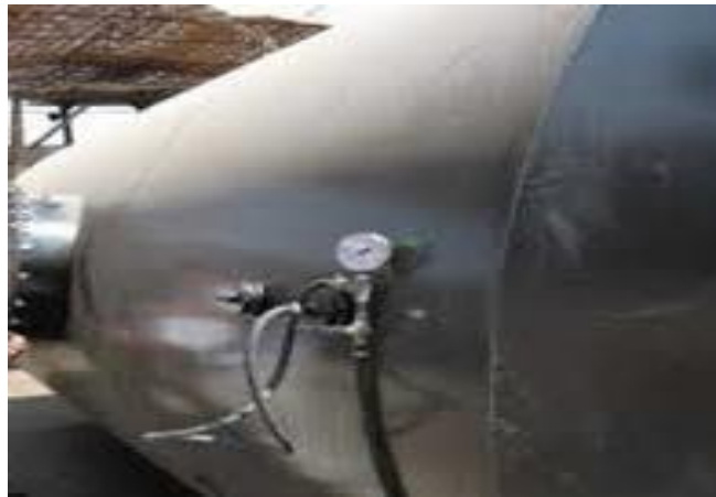
Figura 2.6. Elementos inadecuados para protección de sobrepresión
