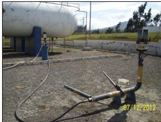
Figura 3.21. Banco de prueba fijo para válvula de alivio
