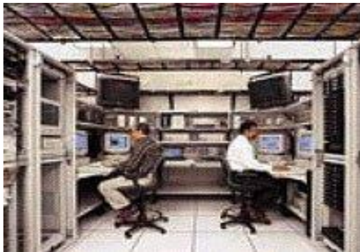
Figura 1. 27 Sala de Equipos [37]
