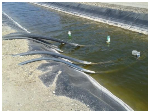
Tomas de agua en el canal del embalse de San Vicente
