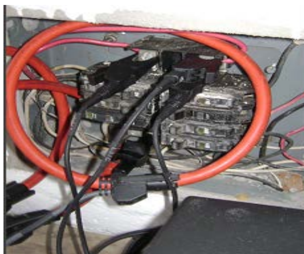
Figura 2.7 Instalación del analizador redes en el TPD de la residencia.
