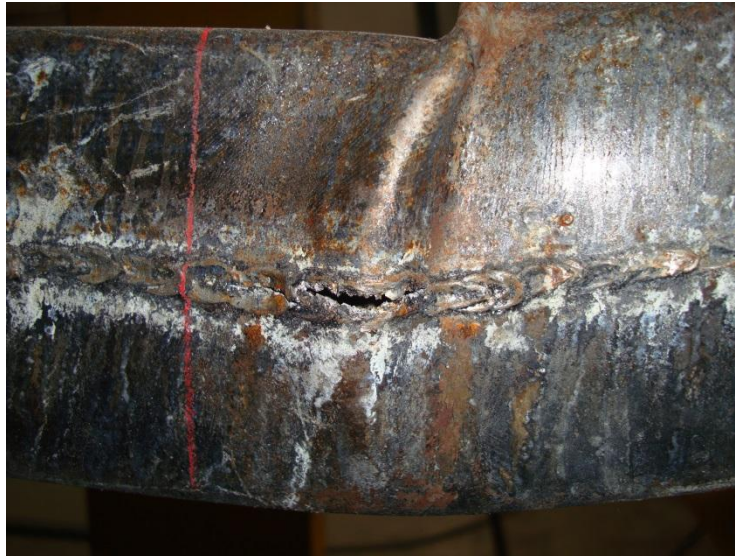
Fotografía 14, 15 y 16: Falla del elemento compuesto armado por soldadura.
