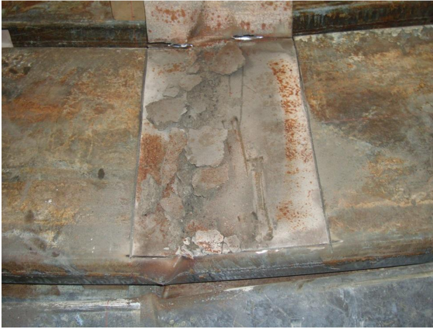
Fotografías 19 y 20: Falla interna del Hormigón.
