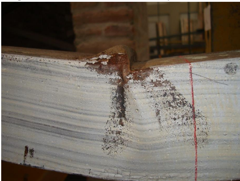
Fotografía 13: Falla del elemento compuesto sin soldar
