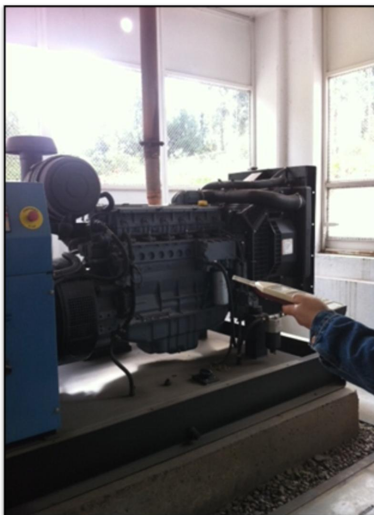
Figura 3.5. Medición de ruido del área del Generador
