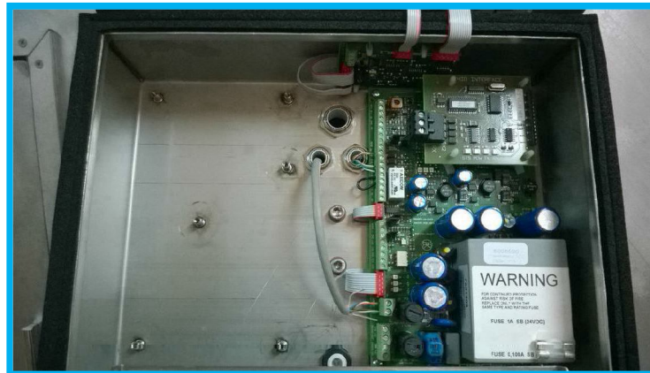
Figura 2. 31 Parte interna de lectora vehicular
