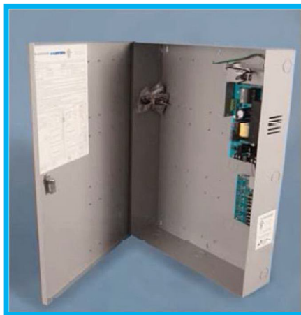
Figura 2. 48 Tablero de control de accesos
