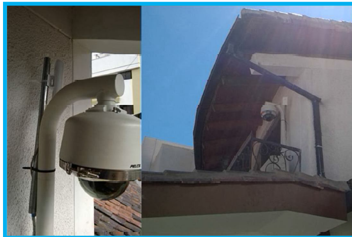
Figura 3. 3 Módulo suscriptor y cámara PTZ montados en conjunto
