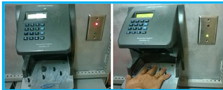
Figura 4. 39 Funcionamiento de handkey y leds de estado
