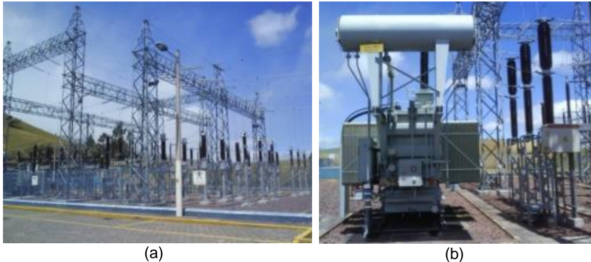
Fig. 1.3 (a) Subestación El Carmen, (b) Transformador e interruptor de potencia de la subestación El Carmen
