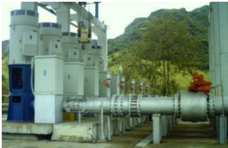
Fig. 1.11 Estación de bombeo Elevadora
