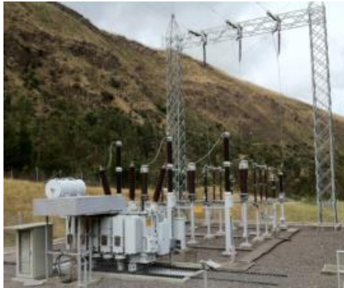
Fig. 1.8 Subestación de la central hidroeléctrica Recuperadora
