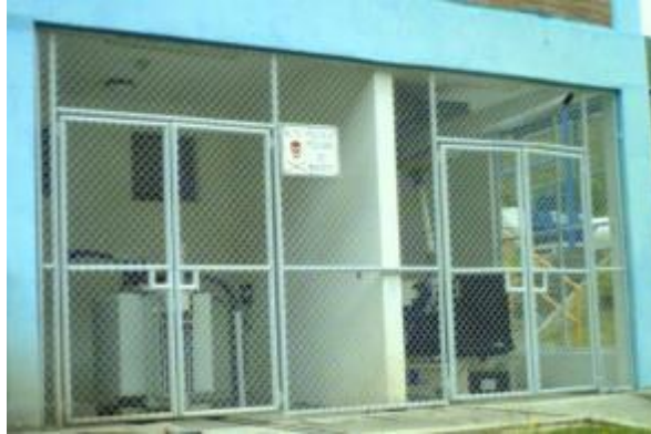
Fig. 1.9 Transformadores de 500 [kVA] y 30 [kVA] correspondientes a los servicios auxiliares
