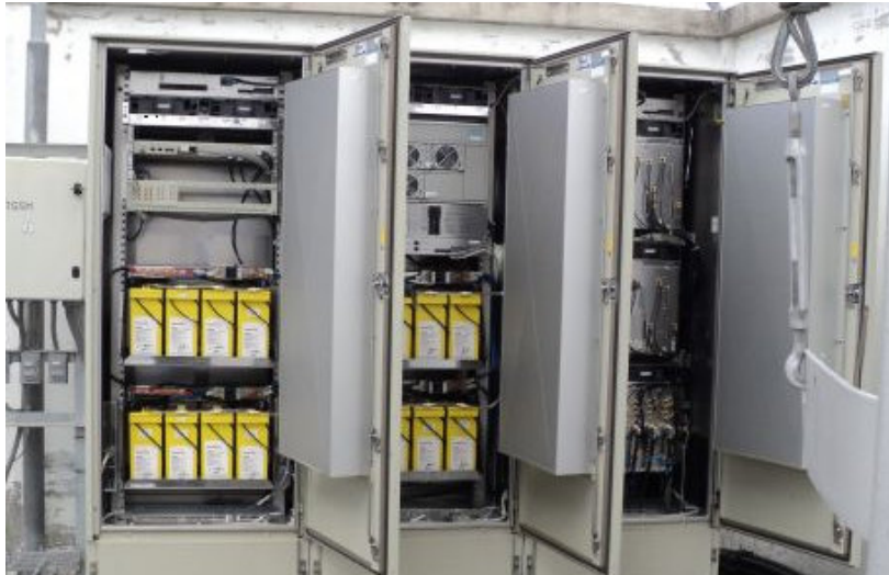
Grafico 18. Equipos de MW, energía DC y Acceso 2G
