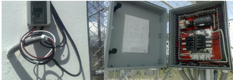
Grafico 17: Medidor de energía, acometida eléctrica y TDE
