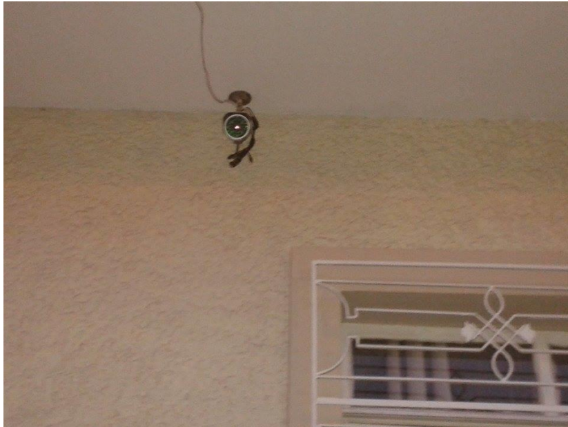
Fig. 40. Cámara IP - Zona A
