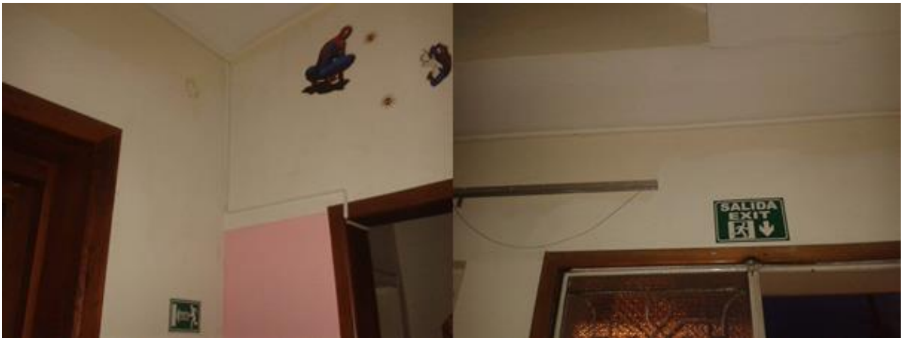
Fig. 46. Red Cableada - Canaletas
