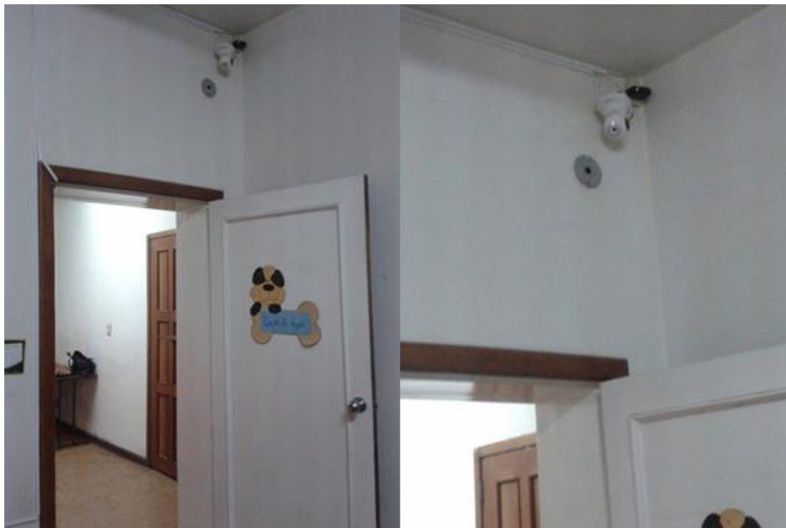
Fig. 43. Cámara IP - Zona B
