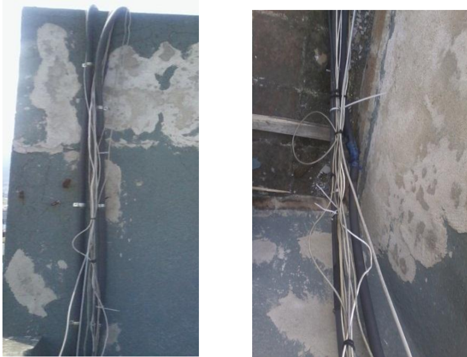
Figura 2.6: Cableado vertical del ISP ECUAONLINE S.A.
