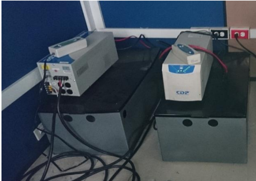
Figura 2.21: Banco de baterías del Cuarto de Equipos de Ecuonline
