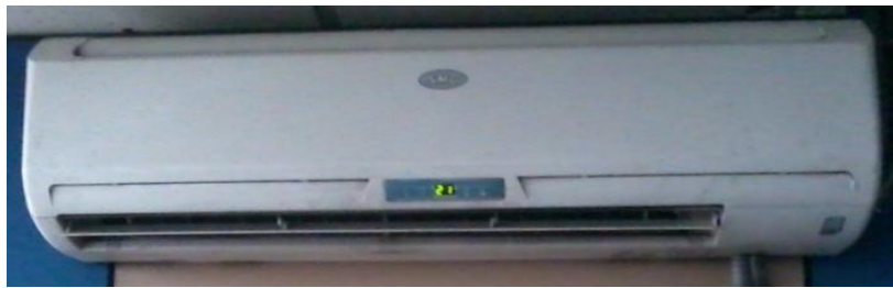
Figura 2.18: Equipo de Aire Acondicionado del Cuarto de Equipos
