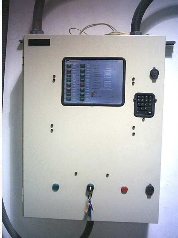
Figura 2.23a Tablero de control (exterior)
