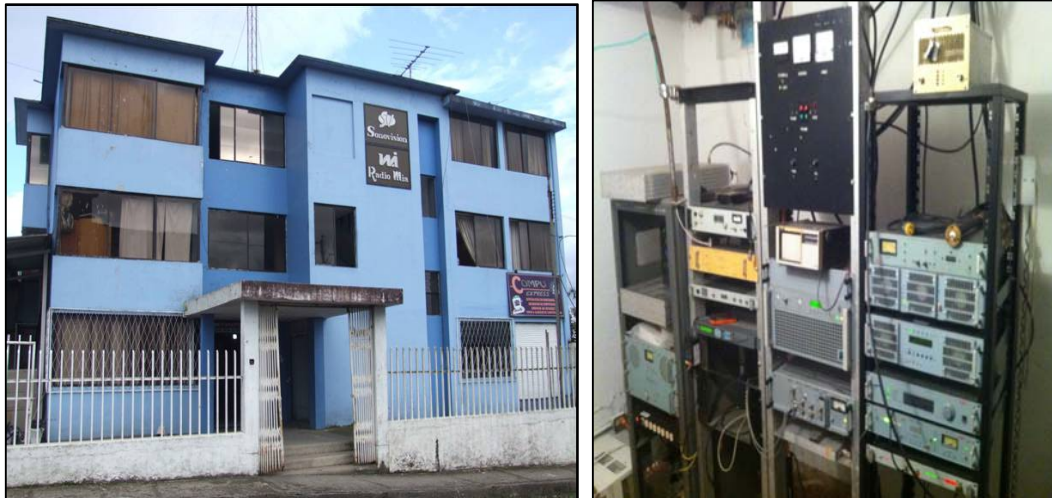
Figura 3.1. Instalaciones de la estación matriz de Radio MIA FM y transmisor principal Cerro Calvario
