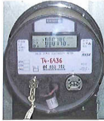
Fig. 3.12: Contador electrónico SIEMENS
