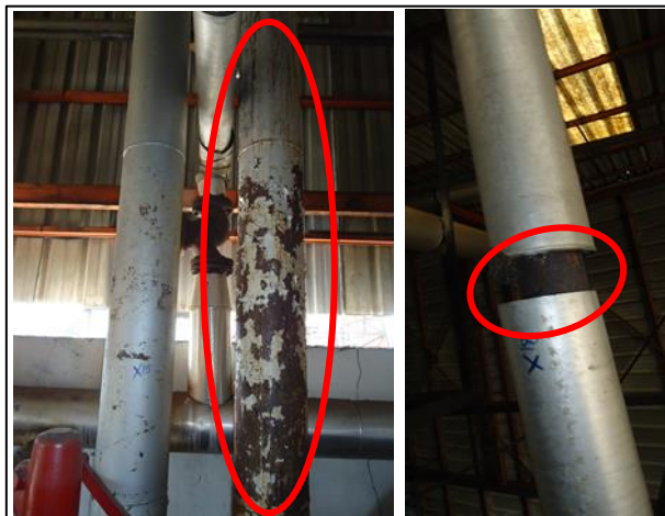
Figura 3.8. Tubería sin aislamiento del área de generación de potencia
