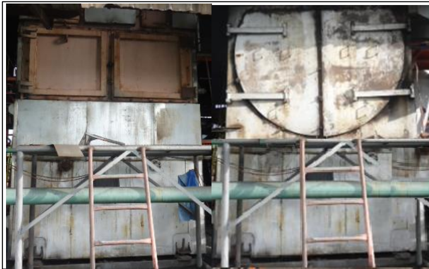
Figura 3.3. Compuertas sin aislamiento de los recalentadores de las calderas 1 y 2
