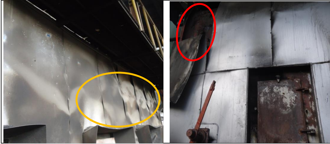
Figura 3.2. Deterioro del aislante de las calderas
