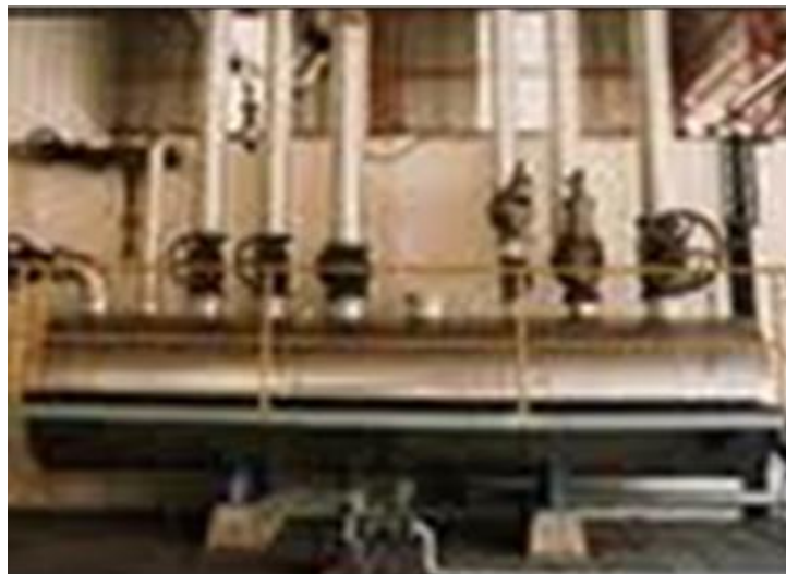
Figura 3.7. Distribuidor de vapor de la fábrica Palmeras del Ecuador
