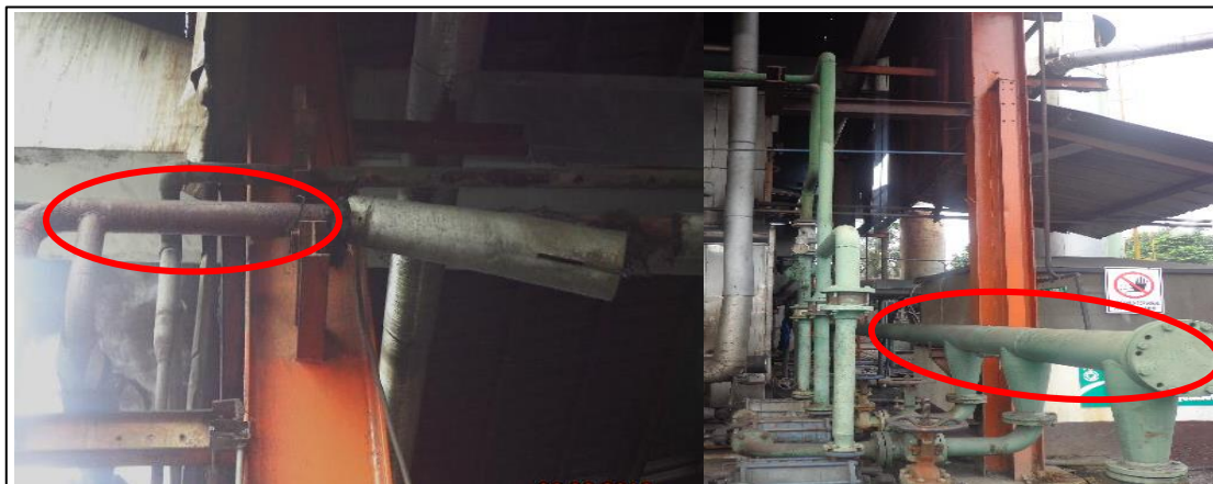
Figura 3.5. Tubería sin aislamiento del tanque de alimentación
