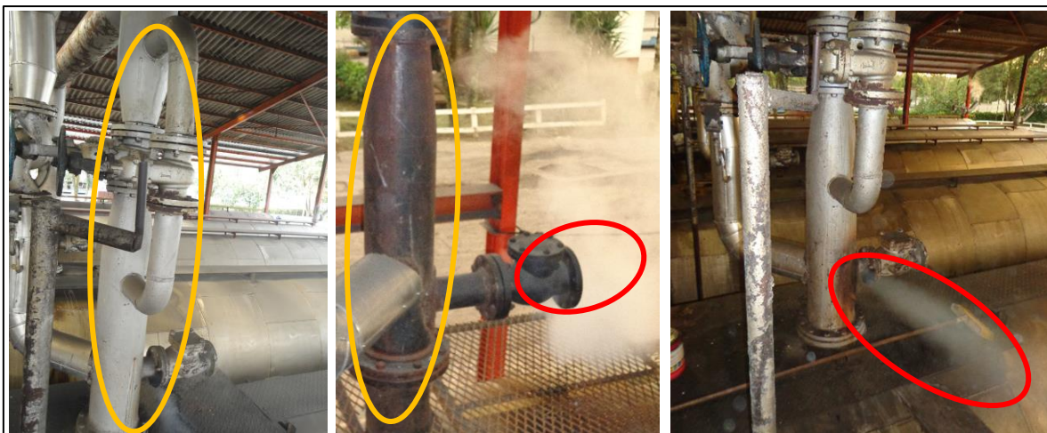
Figura 3.11. Tubería sin aislamiento y con fugas en el área de esterilización
