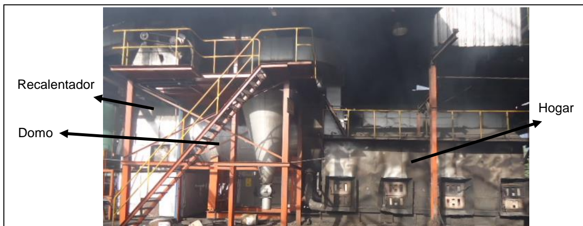
Figura 3.1. Vista frontal de la caldera 1
