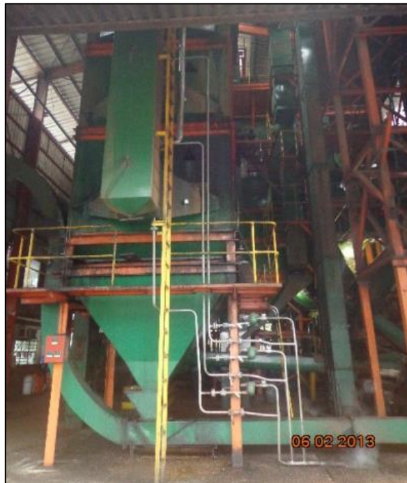
Figura 3.13. Silo de almacenamiento y secado de la fábrica Palmeras del Ecuador
