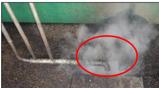
Figura 3.15. Condensado de los silos enviados al desagüe
