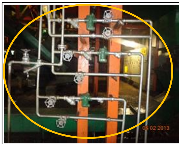
Figura 3.14. Tubería sin aislamiento en el área de palmistería
