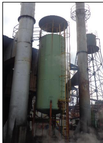
Figura 3.4. Tanque de alimentación de la fábrica Palmeras del Ecuador
