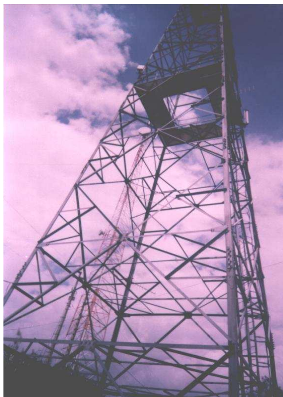
Figura 4. 45 Torre de Transmisión de ANDINATEL S.A. en la localidad de Castilla.
