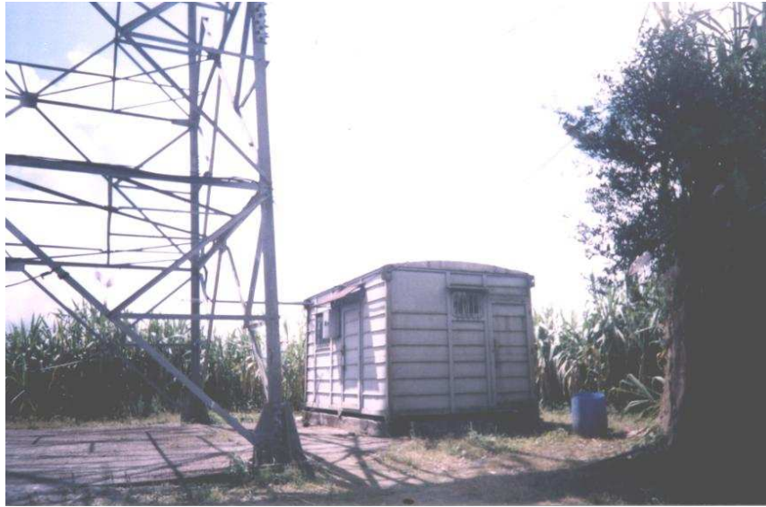
Figura 4. 44 Cuarto de Equipos de ANDINATEL S.A. en la localidad de Castilla
