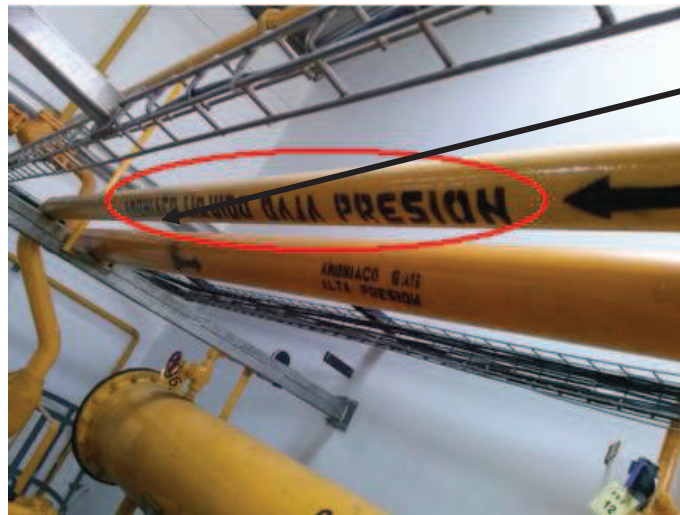
Figura 2.16 Equivocada rotulación de la tubería de retorno de amoníaco líquido del condensador evaporativo
