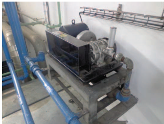
Figura 2.12 Soplador Banco de Hielo Nro. 1
