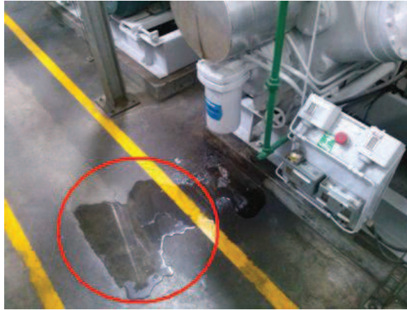
Figura 2.15 Condensación en la tubería de succión del compresor recíprocante 3
