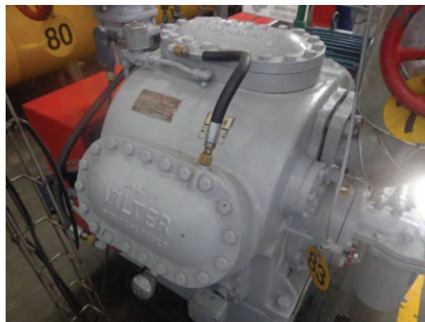
Figura 2.8 Compresor reciprocante Nro.1.
