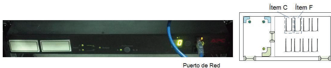
Figura 3.8 ATS modelo “AP7752” presente en el Data Center (C)
