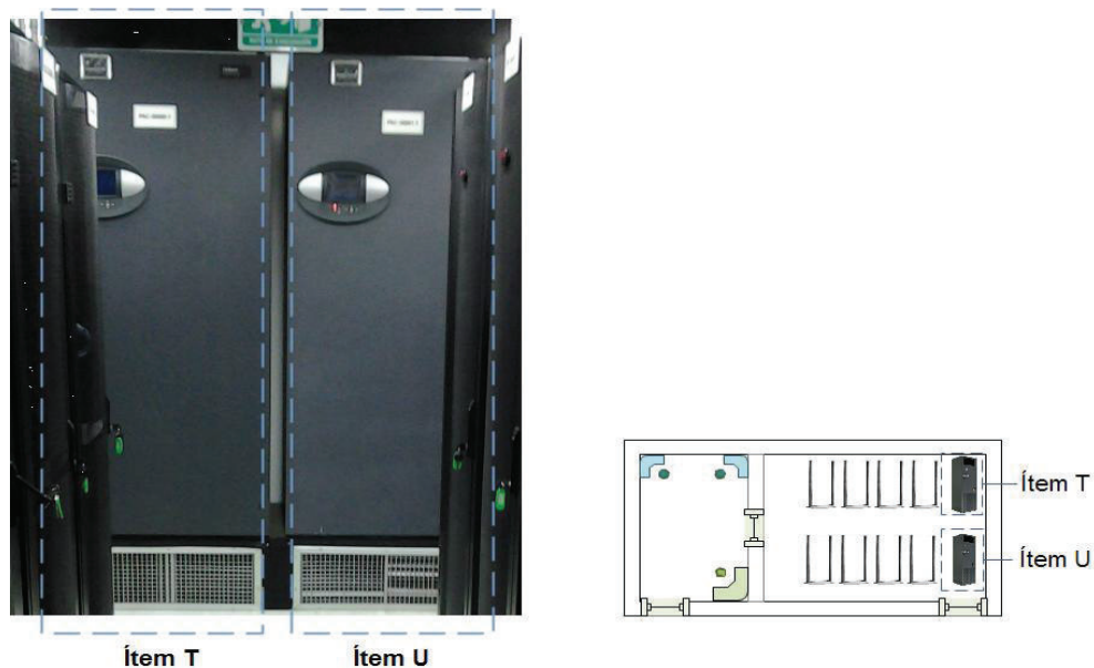
Figura 3.7 Aires acondicionados de precisión modelo "BF-067" presentes en el Data Center (T y U)
