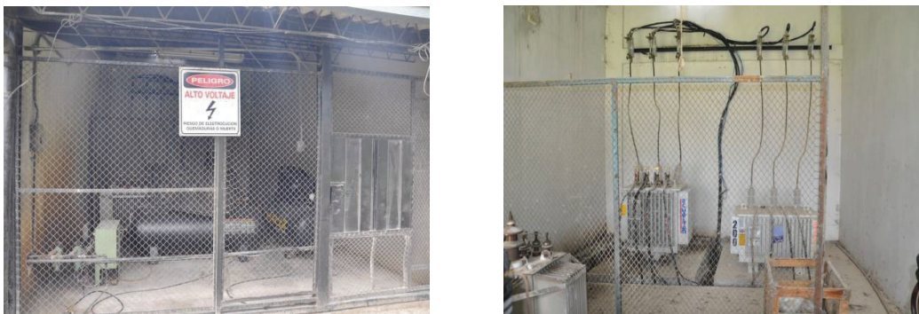
Fig. 3-1 Cámara de Transformación.
