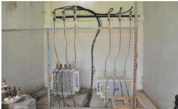
Fig. 4-10 Cámara de Transformación del Fábrica El Troje.
