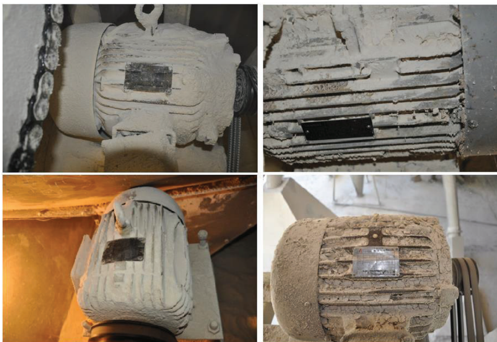
Fig. 4-22 Acumulación de polvo en el exterior de motores.
