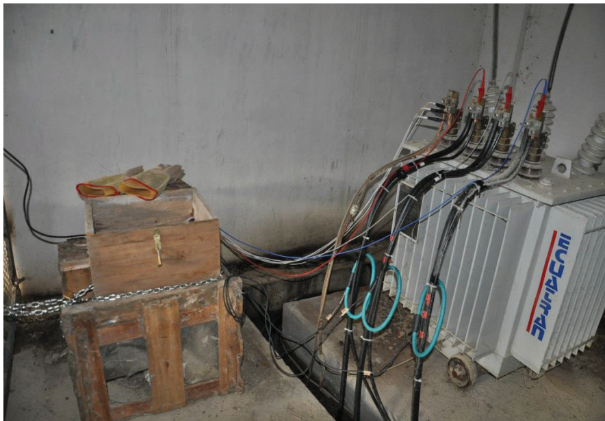
Equipo de Medición instalado y operando.
