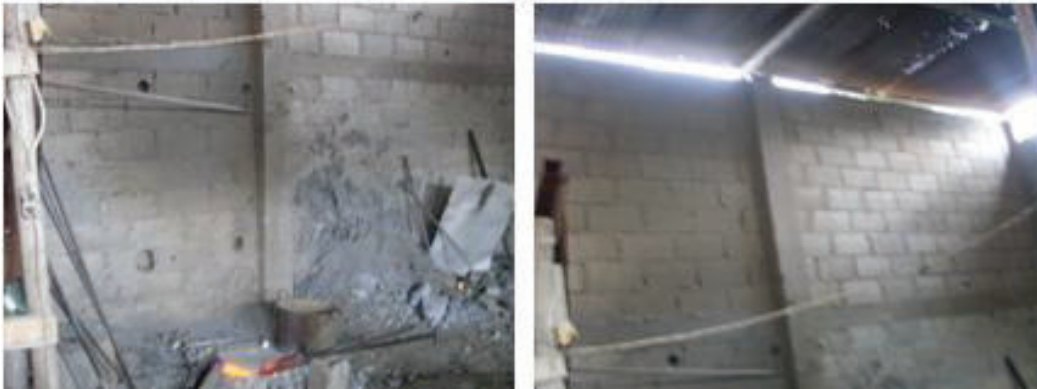
Figura 4.46: Efectos de los gases en el área de hornos (Fundidora 6)
