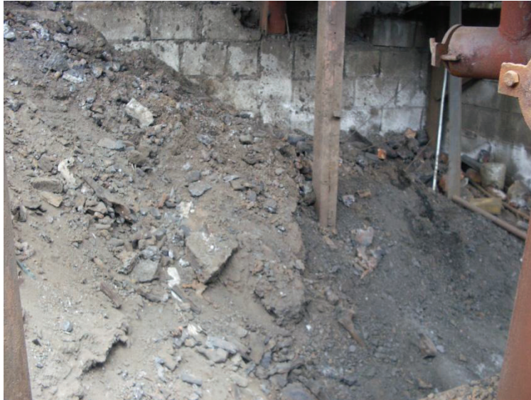
Figura 4.41: Área de escorias
