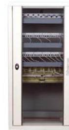
Btnet Cableado estructurado
