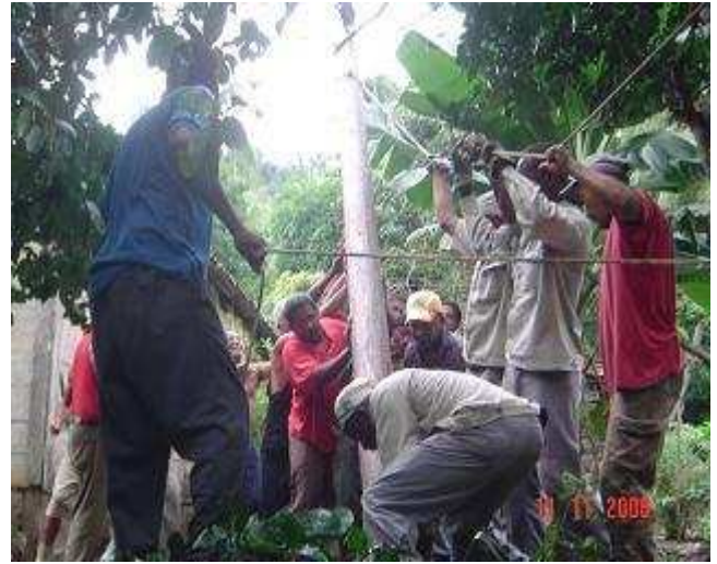
Avería en la conductora mini Montaje de postes y líneas eléctricas Arroyón I fecha 14/03/2006 micro Los Gallegos 18/12/2006
