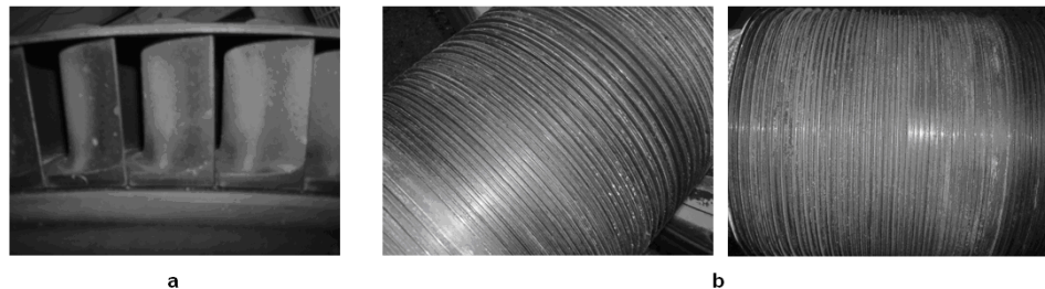
Figura 10. Fotografías de la turbina 1 mostrando el buen estado técnico de alabes (a) y sellos (b).
