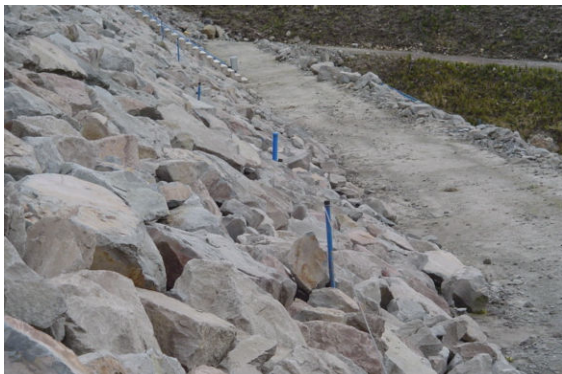
Figura 1. En color azul se observan algunos de los 15 sensores de rompimiento en la pared de la Presa Salve Faccha.
