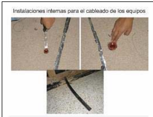
Figura 17. Instalaciones para el cableado
