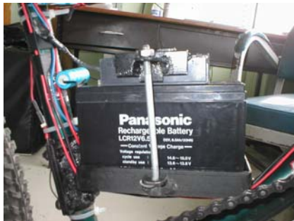
Figura 8 Baterías de Control y Potencia
