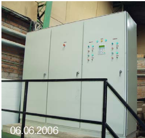
Figura 8 Vista armario eléctrico
