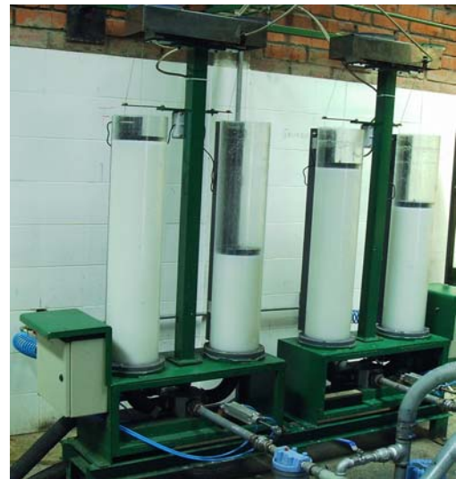
Figura 4 Vista nuevo sistema cuenta litros
